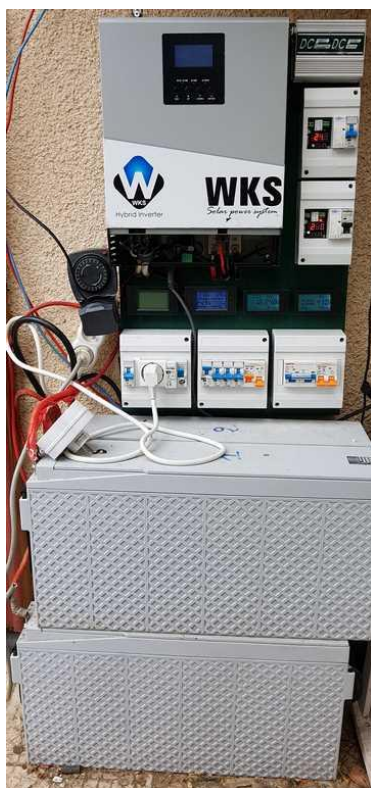
Station avec ses quatre batteries 24VDC
